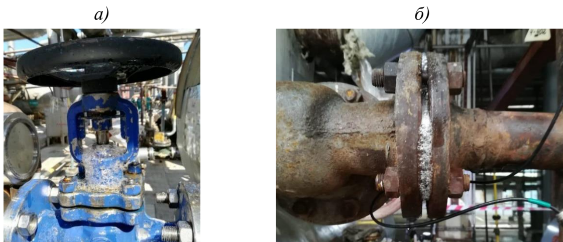
Рисунок 13 – Фотографии типичных дефектов, обнаруженных при проведении контроля: пропуск в прокладке штока запорной арматуры (а) и во фланцевом соединении (б)
